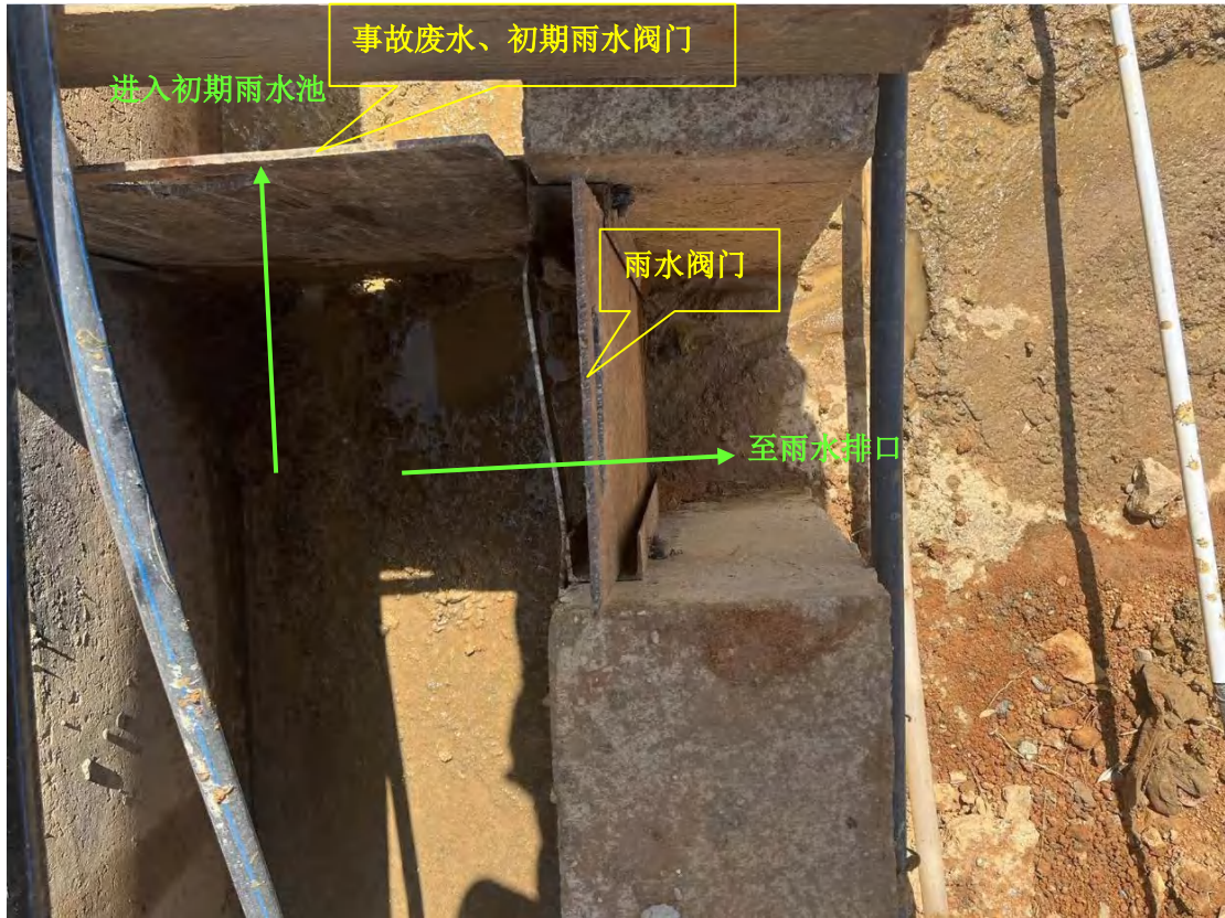
图 4.3-1 事故废水、初期雨水、后期雨水切换阀
