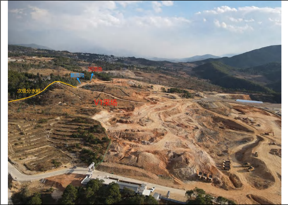
北侧山脊线次级分水岭及 V1 采场东侧截洪沟及沉淀池
