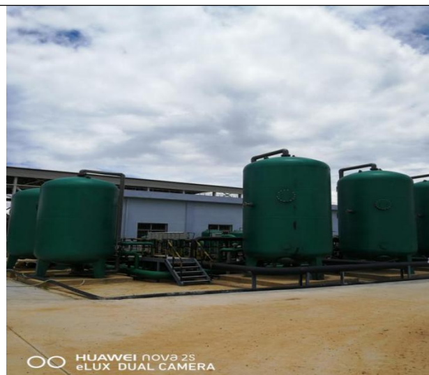
污水处理系统
