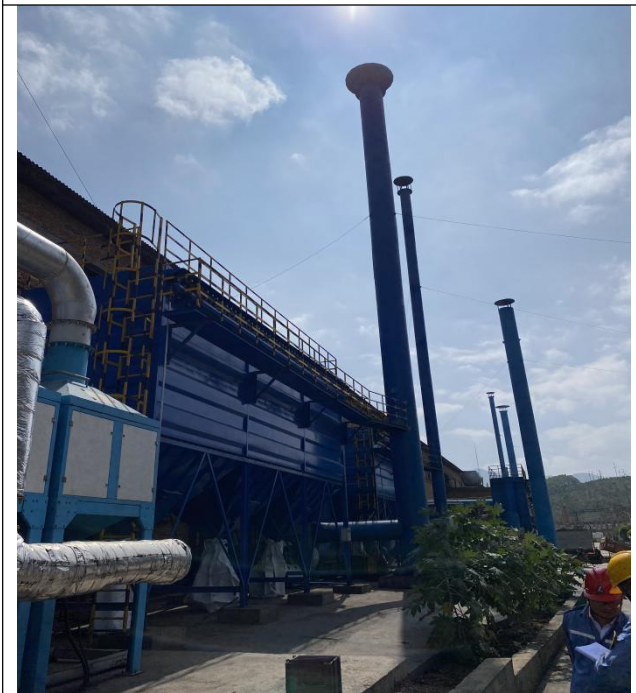
废气处理系统+排气筒
