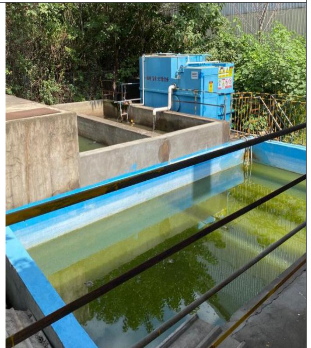
生活污水处理设施
